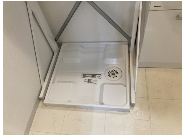
8.洗濯機防水パン
